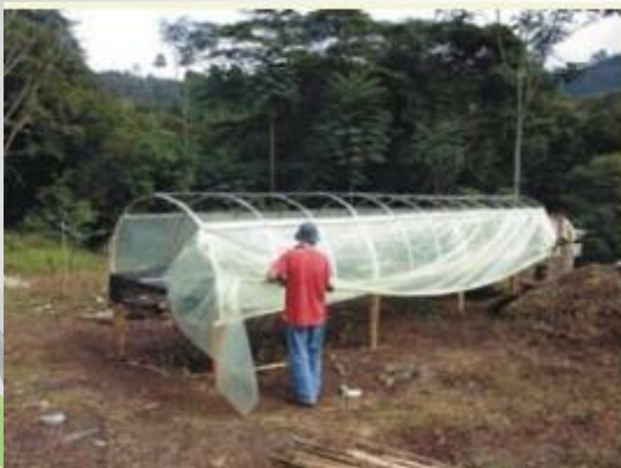
Figura 41. Construcción de la cumbre: a) Fijación del primer lado y preparación para extender el plástico.
