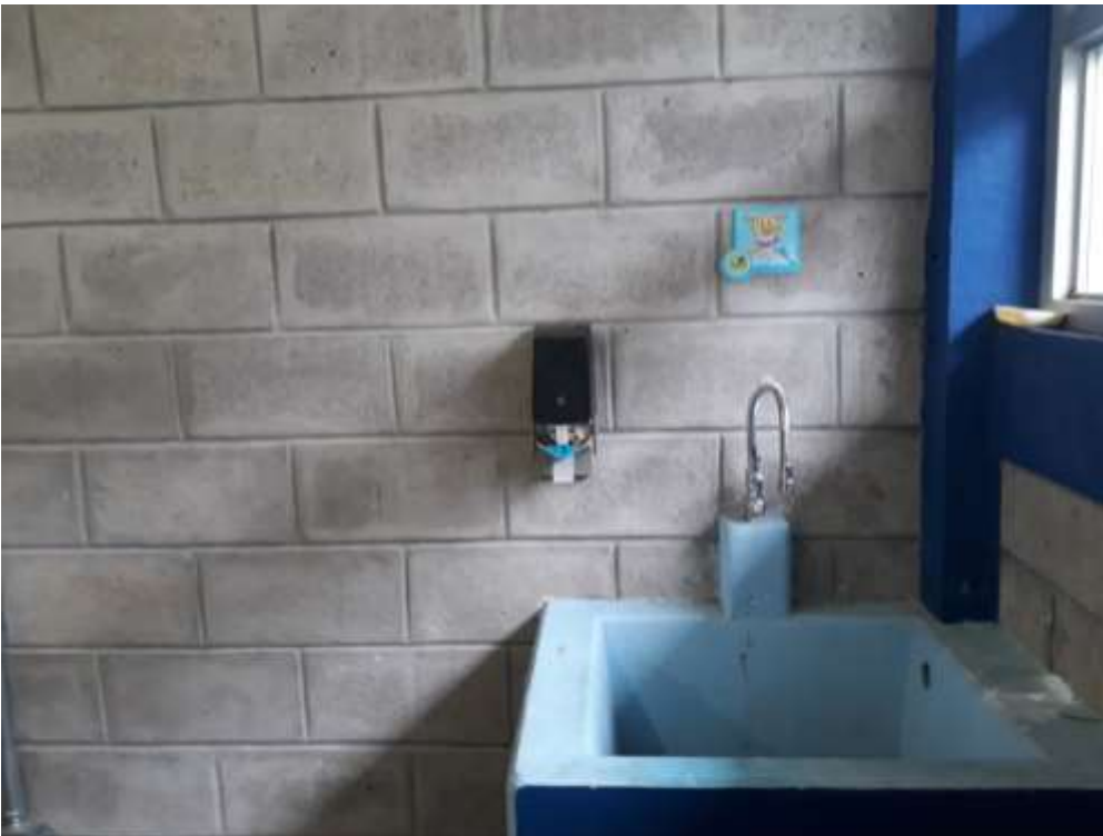
Pila para lavamanos, se colocará dispensador de alcohol y de jabón.
